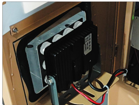
机箱内补光灯的安装
